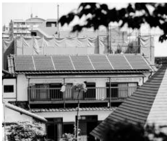
太陽光パネル
